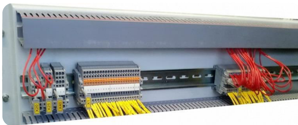
Рисунок 2.6 – Внешний вид устройства вводно-защитного постов ЭЦ ВЗУ-ЭЦС-М (клеммная панель)
